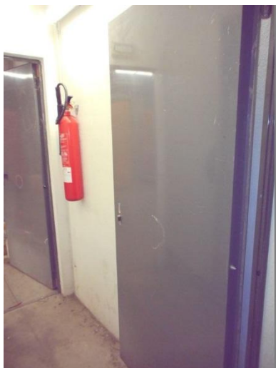
EXTINTOR SIN SEÑALIZAR
