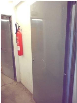
EXTINTOR SIN SEÑALIZAR
